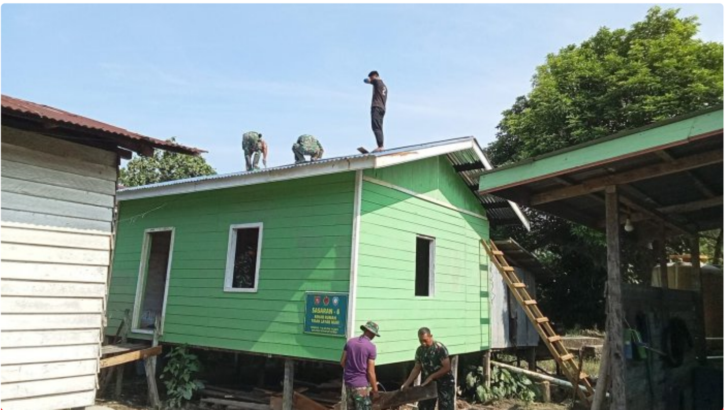
Satgas TMMD ke- 118 Wiltas Kodim 0910/Malinau Pasang Atap RTLH milik Bapak Carles
